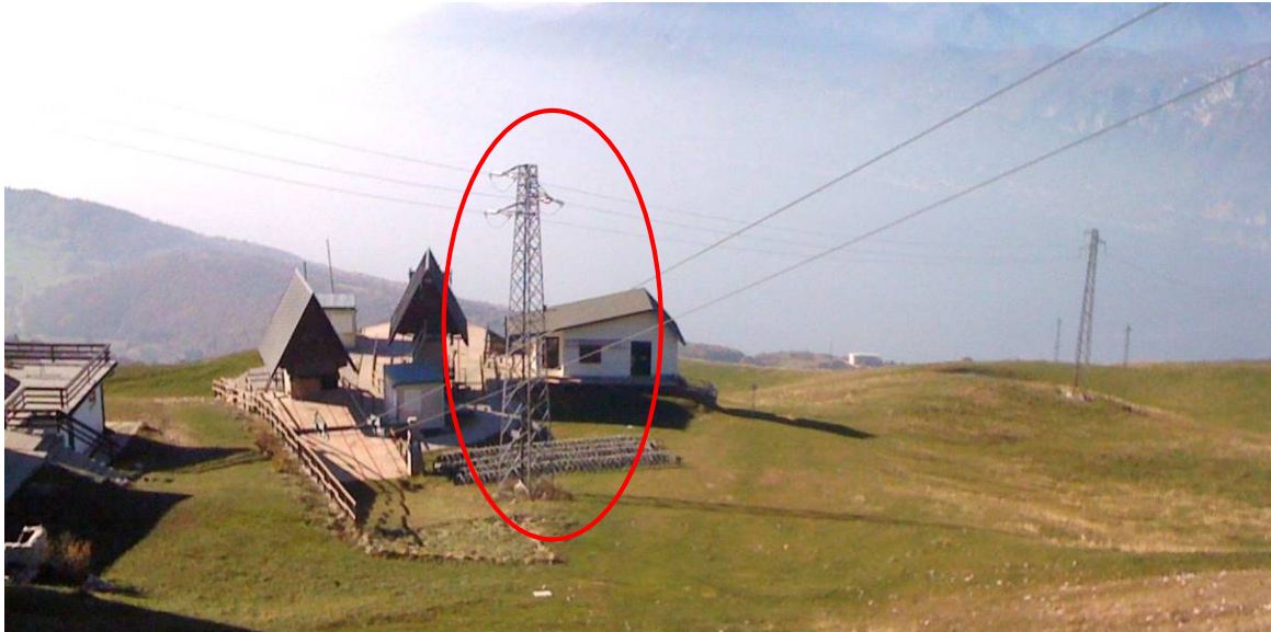
Traliccio della media tensione situato subito a monte delle stazioni di scambio tra bidonvia e seggiovia.
